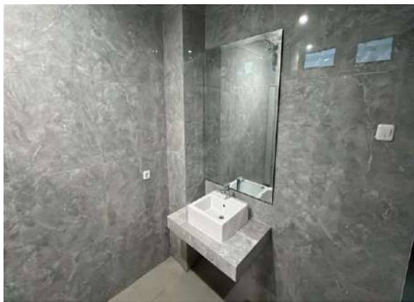
Spot Wastafel Dalam Toilet
